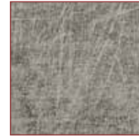
B-134 Hormigón Arañado
